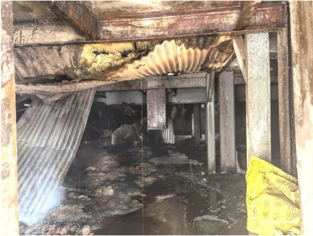
图 4 事故现场图片
